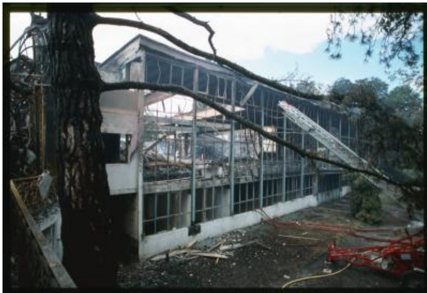
Il Pavillon du Désarmement il giorno seguente l'incendio del 1987
