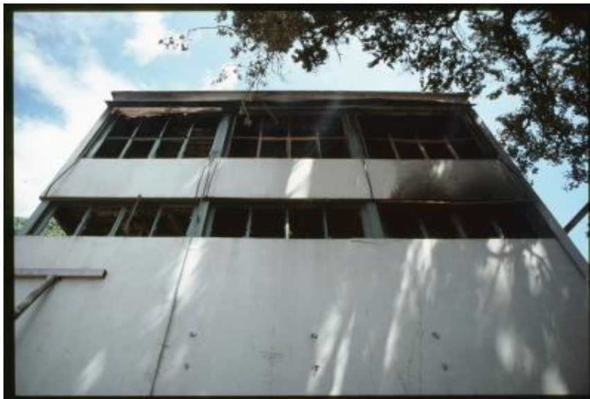
Dettaglio del Pavillon du Désarmement il giorno seguente l'incendio del 1987
