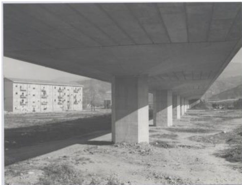
Sopraelevata urbana a Cosenza per il raccordo della S.S. 107 con l'autostrada Salerno-Reggio Calabria
