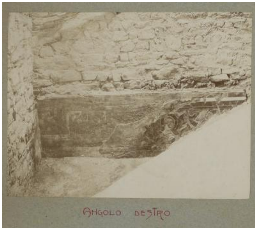
Dettaglio dell'antico soffittone in legno della Cattedrale di San Lorenzo in Lugano
