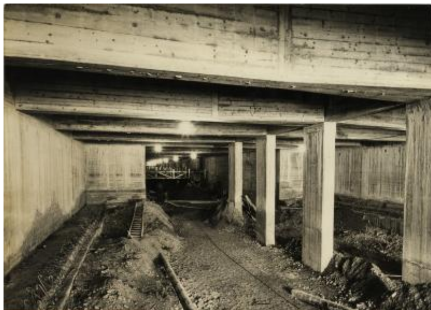
Galleria della linea 1 della metropolitana tra la stazione Buonarroti e via Giotto a Milano
