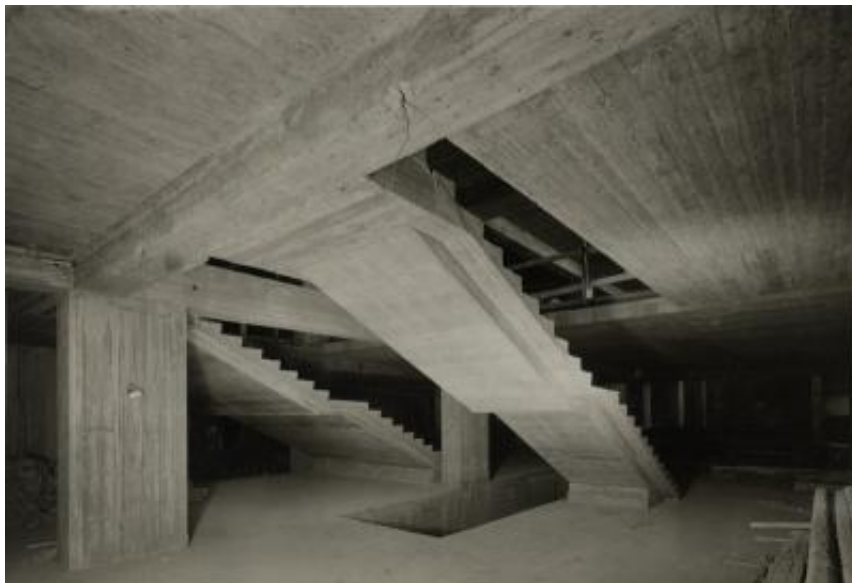
Particolare delle scale di accesso al piano banchine della stazione Cadorna a Milano
