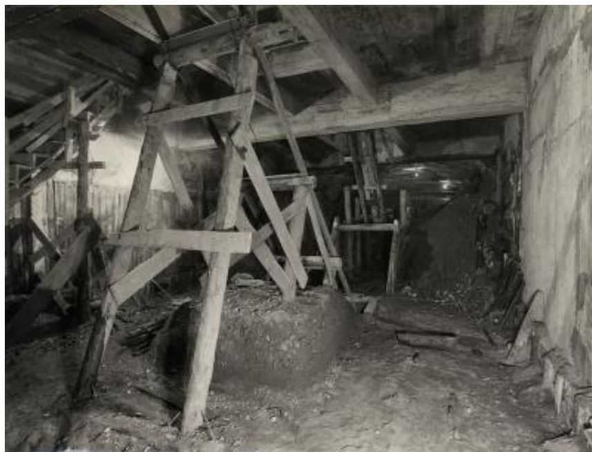
Scavo di avanzamento per l'esecuzione dei piedritti della linea n. 2 nel cantiere di Santo Spirito a Milano
