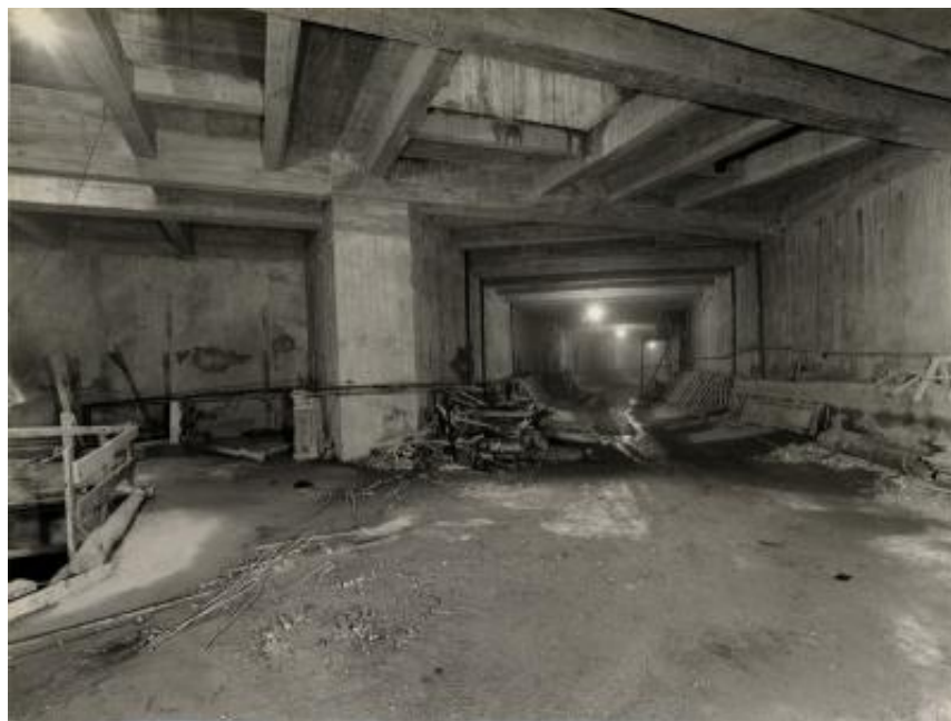
Manufatto d'incrocio delle linee 1 e 2 della metropolitana sotto piazza Castello, visto da via Minghetti a Milano
